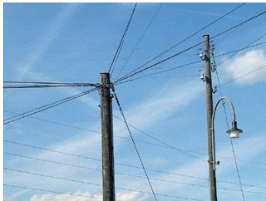
In Iberg werden die Glasfaserkabel via Telefonmasten in die Häuser geführt. Bild: hmo
